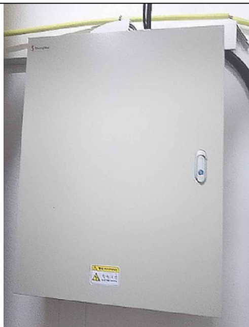
FOTO DO PAINEL QDF AUXILIAR
